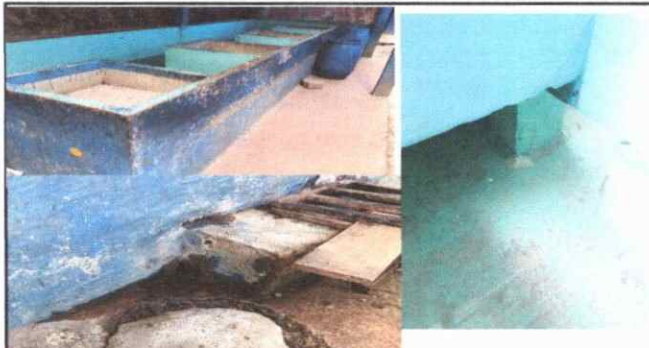
Foto 3: Pila en mal estado y con fugas de agua.
